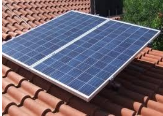
Σχήμα 2. Τυπικό φωτοβολταϊκό σύστημα στη σκεπή ενός σπιτιού.
