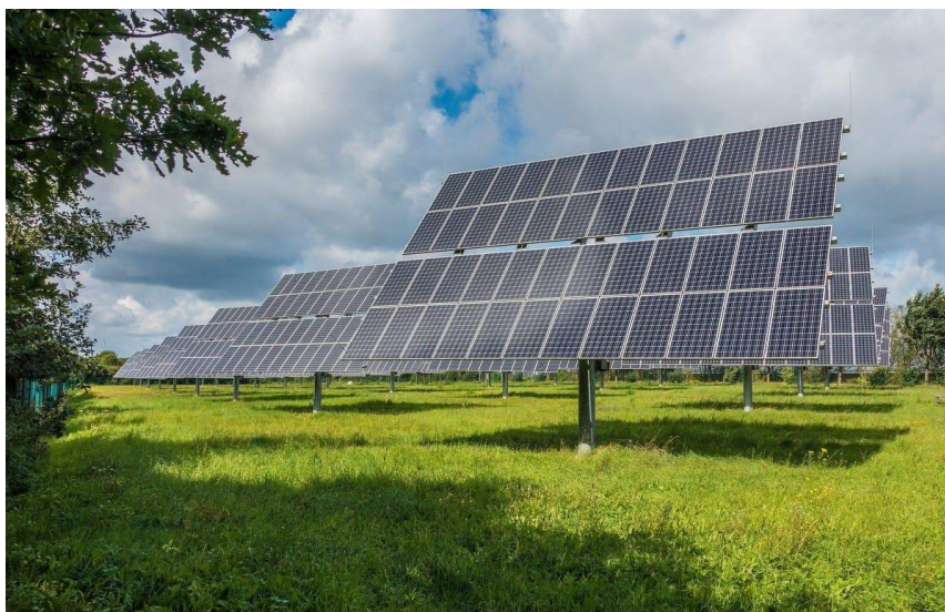
Εικόνα 1-3 Φωτοβολταϊκό Πάρκο σε περιστρεφόμενες βάσεις
