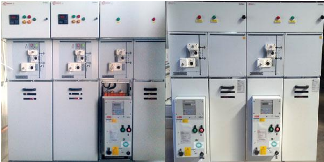
Εικόνα 1-17 Πίνακες χειρισμών Μέσης Τάσης
