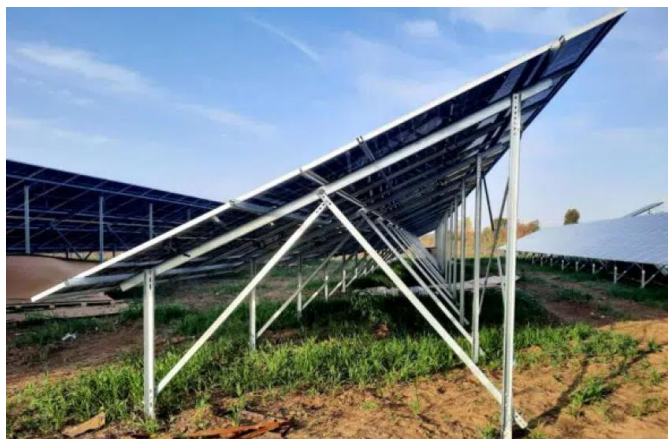
Εικόνα 1-13 Σταθερή Βάση Φωτοβολταικών Πάνελ
