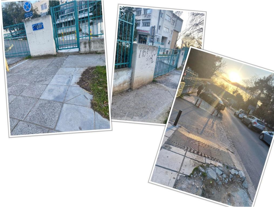
Εικόνα 17: Απεικόνιση της γενικότερης κατάστασης του οδοστρώματος και της έλλειψης συστήματος οδηγού όδευσης από τη δεξιά και την αριστερή πλευρά της εισόδου
