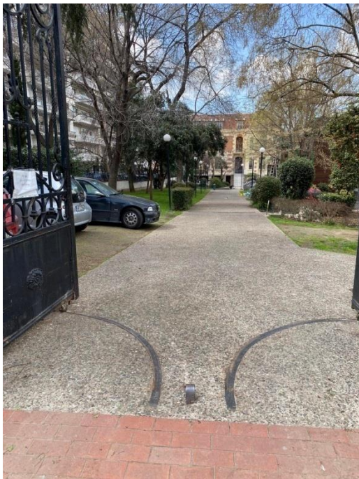
Εικόνα 36: Απεικόνιση της απουσίας οδηγού όδευσης τυφλών στη διαδρομή που οδηγεί το άτομο από τον αύλειο χώρο του μουσείου προς την είσοδο στον εσωτερικό χώρο
