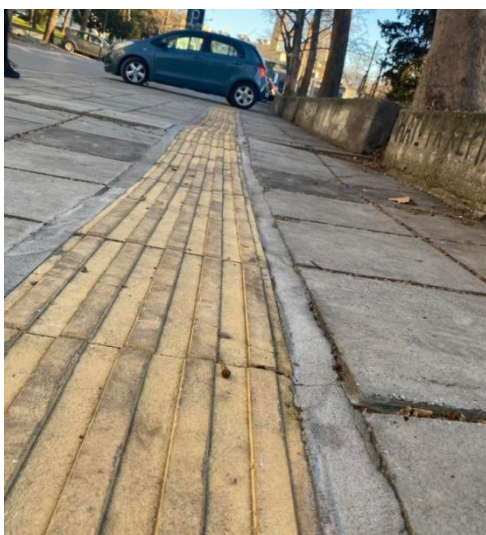
Εικόνα 12: Απεικόνιση σταθμευμένων οχημάτων επάνω στον οδηγό όδευσης τυφλών
