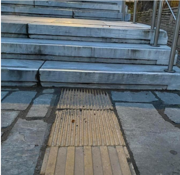
Εικόνα 42 : Απεικόνιση της αρχής του κλιμακοστασίου όπου εντοπίζονται πλακίδια τύπου Δ-ΕΞΥΠΗΡΕΤΗΣΗ, ενώ, στην αρχή και στο τέλος κεκλιμένων επιπέδων (ραμπών) και κλιμάκων, καθ'όλο το πλάτος αυτών και σε απόσταση 0,30μ από τη συμβολή της ράμπας με τα οριζόντια επίπεδα ή την ακμή της πρώτης και της τελευταίας βαθμίδας, τοποθετούνται πάντοτε πλακίδια τύπου Β-ΚΙΝΔΥΝΟΣ, τα οποία διαθέτουν έντονες φολίδες τοποθετημένες σε τετράγωνο κάναβο με διάταξη διαγώνια προς την κίνηση των πεζών
