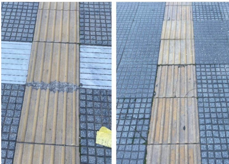
Εικόνα 18: Φθορές που εντοπίζονται στο πεζοδρόμιο επάνω στο οποίο βρίσκεται η δεύτερη είσοδος του νοσοκομείου
