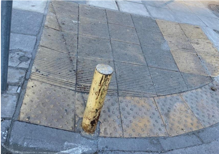
Εικόνα 4: Απεικόνιση μικρής μεταλλικής κολώνας η οποία βρίσκεται αρκετά μέσα στην περιοχή στην οποία πιθανόν να κινείται το άτομο
