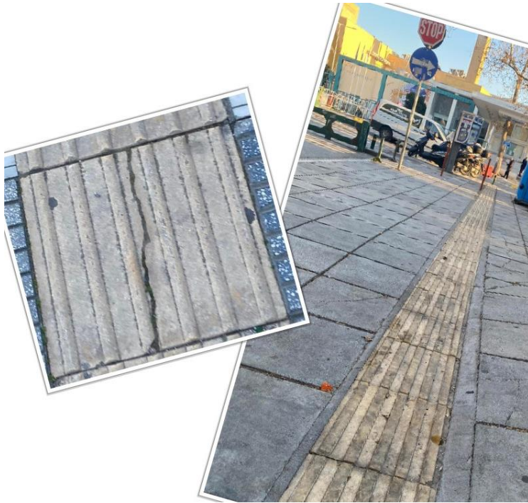
Εικόνα 13: Απεικόνιση φθορών , ρωγμών και κακής κλίσης του οδηγού.
