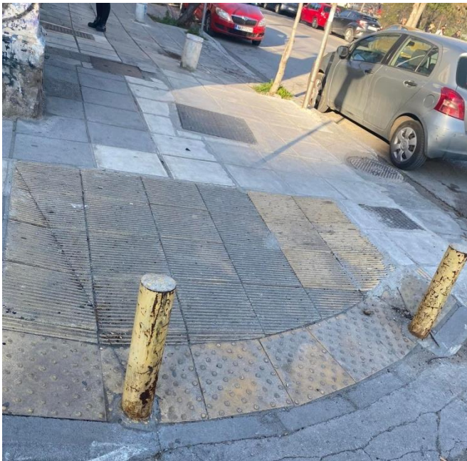
Εικόνα 3: Απεικόνιση των βοηθητικών πλακιδίων που εντοπίζονται στην αρχή του πεζοδρομίου, επάνω στο οποίο εντοπίζεται η είσοδος του νοσοκομείου
