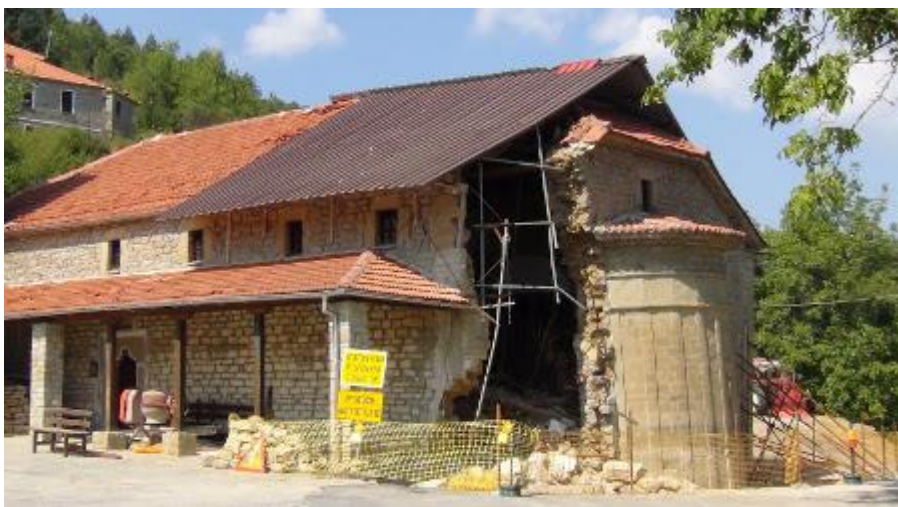
Εικόνα 3 : Η κατάσταση της εκκλησίας, μετά την καταστροφή
