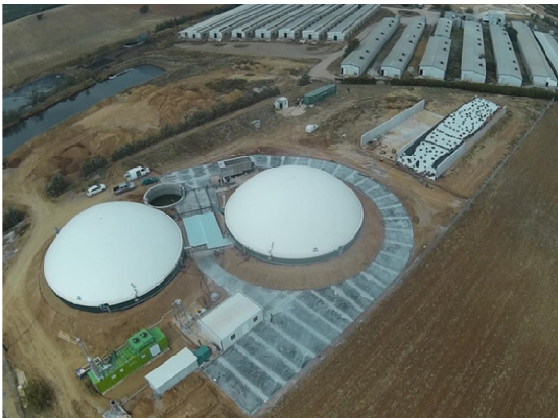
Εικόνα 27 Μονάδα παραγωγής Βιοαερίου στη Χαλκιδική
