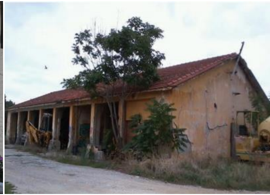
Εικόνα 58: Κτίριο σε μέτρια κατάσταση
