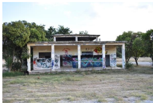
Εικόνα 59: Κτίριο σε κακή κατάσταση
