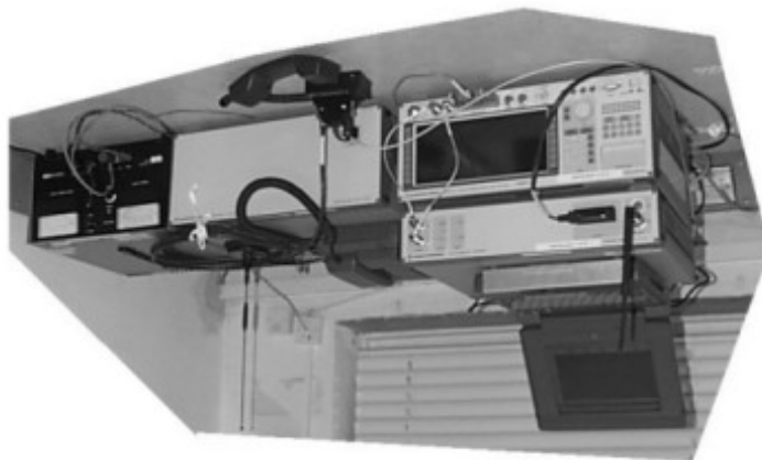
Σχήμα 36. Ψεύτικος σταθμός βάσης (BTS)
