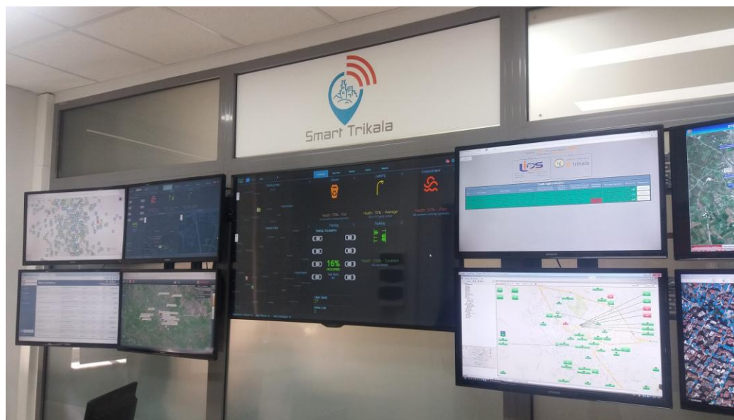
Εικόνα 4: Το control room του νέου πιλοτικού προγράμματος του Δήμου Τρικκαίων [10].
